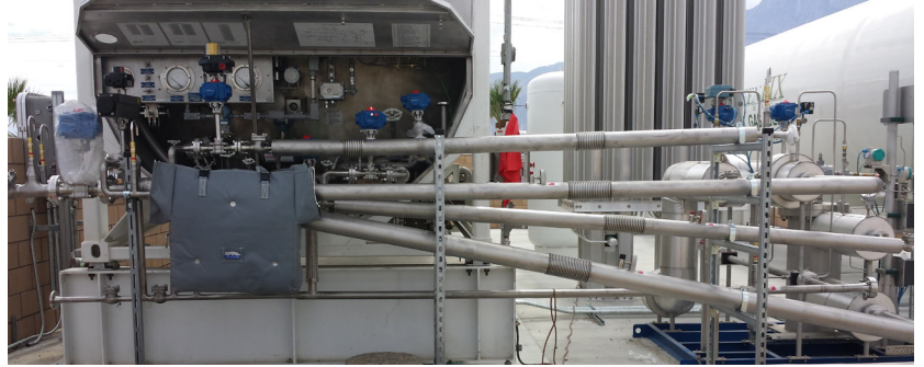
LNG Vacuum Insulated Lines
